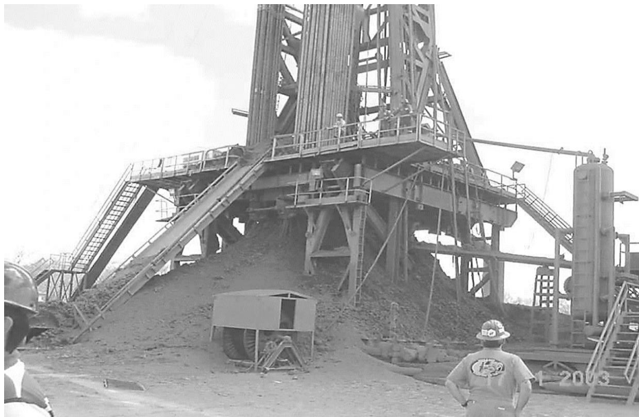
Imagen 4. Blow Out durante la perforación del hoyo intermedio en el campo San Joaquín
